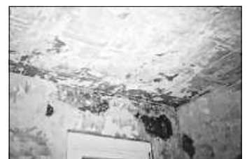
Schimmel an der Decke Fotos: DRK
