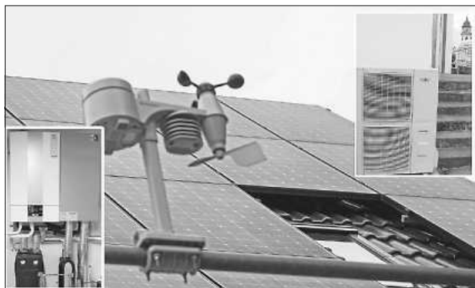
Photovoltaik und Wärmepumpe in sinnvoller Ergänzung
