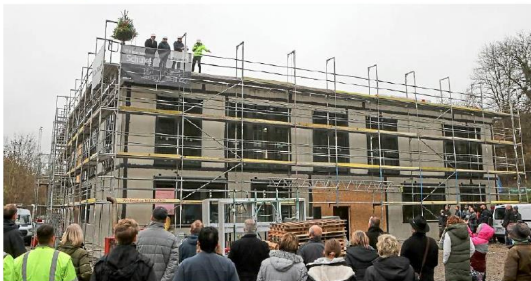
Steigen der neuen Gemeinschaftsschule in Schwieberdingen schon einmal aufs Dach: Die Bürgermeister Nico Lauxmann und Thomas Schäfer, Schulleiterin Silke Benner und Bauleiter Manuel Josten.
