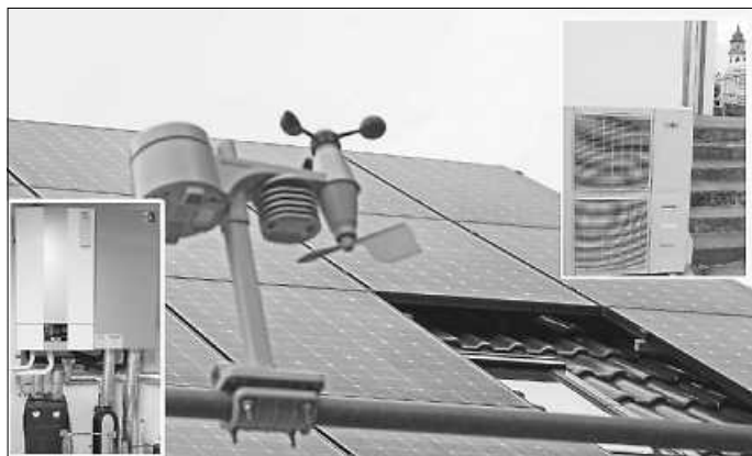
Photovoltaik und Wärmepumpe in sinnvoller Ergänzung.
