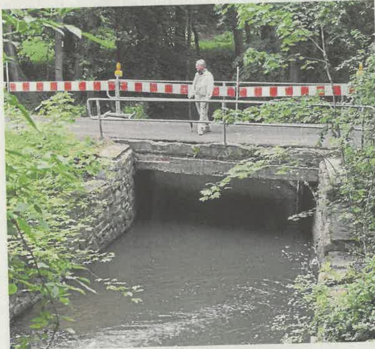
Immer wieder hat Hochwasser die Schwieberdinger Glemsbrücke in der Vergangenheit in Mitleidenschaft gezogen.
